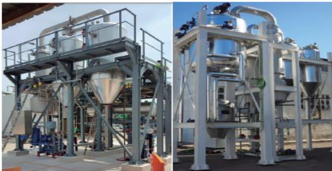
Equipos para el tratamiento de aguas residuales en la industria papelera. (Navarrete, 2022).
